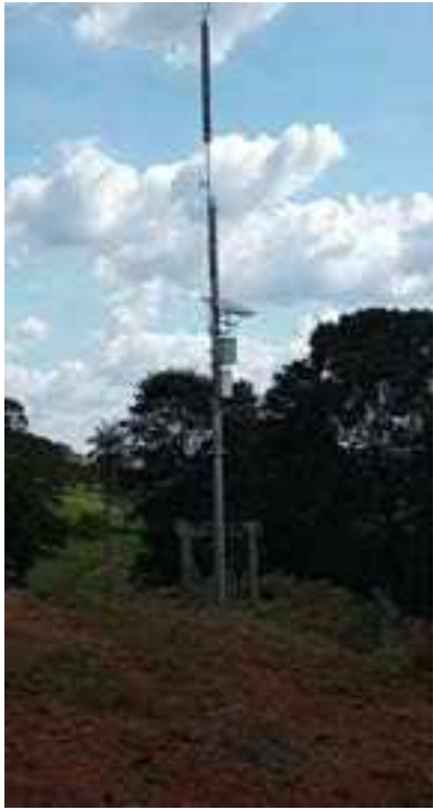
Visita de campo - Instalação da Sirene 3 . EuroChem, Serra do Salitre (MG), 16/03/2023.
