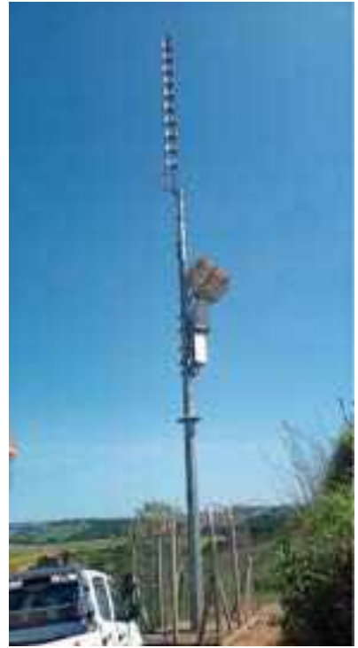
Visita de campo - Instalação da Sirene 4 . EuroChem, Serra do Salitre (MG), 16/03/2023.
