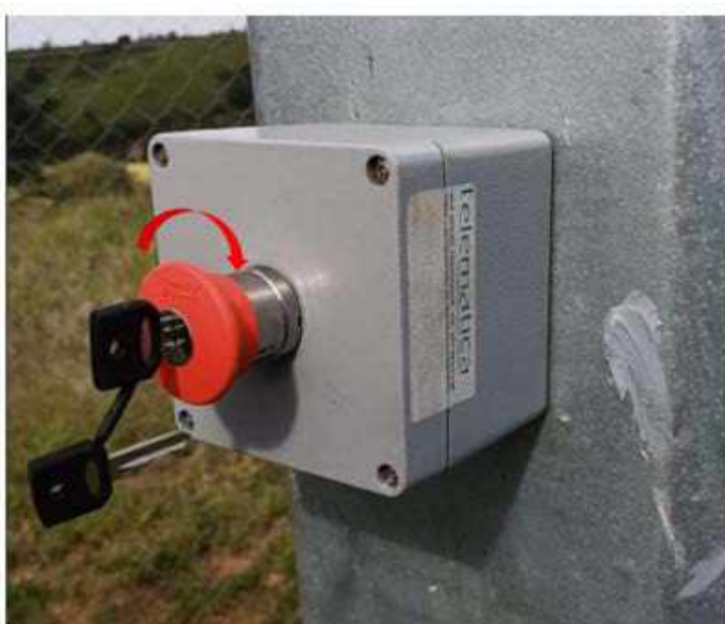
Figura 8.3-4 – Botoeira de emergência (acionamento manual)
