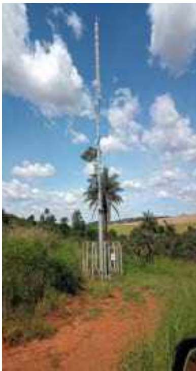
Visita de campo - Instalação da Sirene 7 . EuroChem, Serra do Salitre (MG), 16/03/2023.
