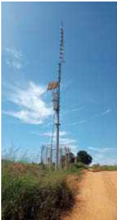
Visita de campo - Instalação da Sirene 5 . EuroChem, Serra do Salitre (MG), 16/03/2023.
