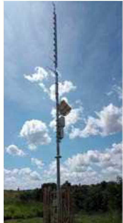
Visita de campo - Instalação da Sirene 2 . EuroChem, Serra do Salitre (MG), 16/03/2023.
