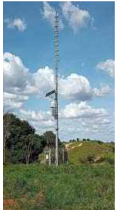
Visita de campo - Instalação da Sirene 6 . EuroChem, Serra do Salitre (MG), 16/03/2023.
